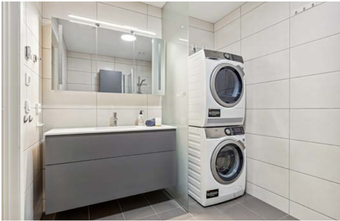
Opplegg for vaskemaskin og tørketrommel
