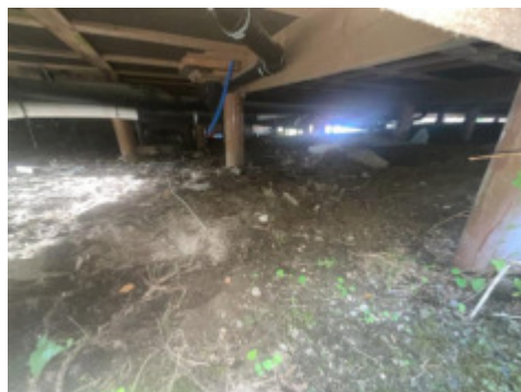
Eventuelt lekkasjevann ledes ut under fritidsbolig.
