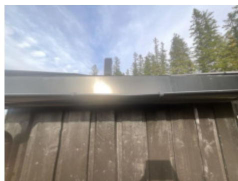
Deformasjon på renne.
