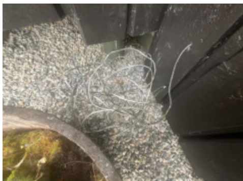
Løs ledning på hyttevegg.
