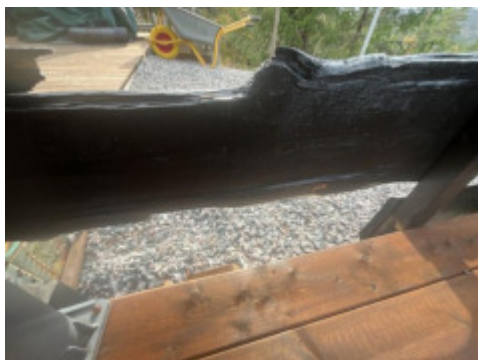
Råte i rekkverk.
