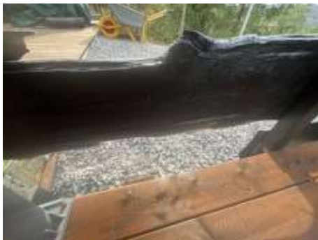
Råte i rekkverk.
