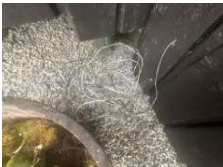
Løs ledning på hyttevegg.
