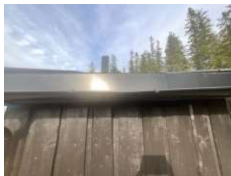
Deformasjon på renne.
