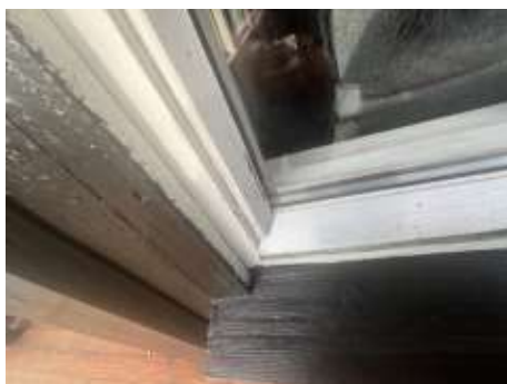
Vær/aldersslitasje på vindu.
