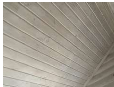
Løs ledning i himling.
