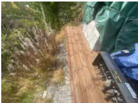
Fall på over 0.5m uten rekkverk.
