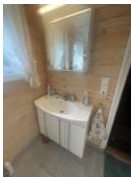
Vask med baderomsinnredning.
