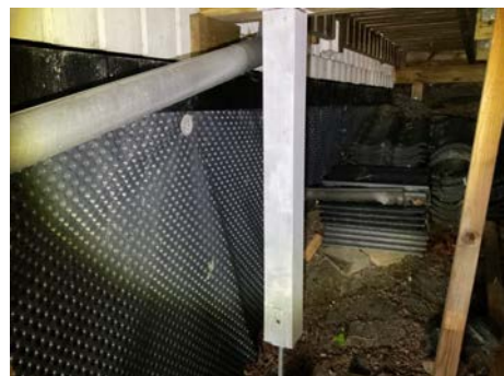
Synlig grunnmursplast registrert på tilbakefylt del.
