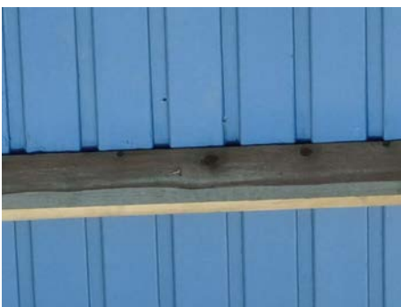
Vannbord på vegg.
