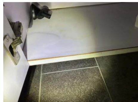
innredning har skader
