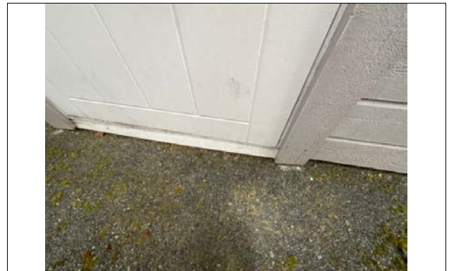
Dørblad i boden har fuktsvelling i bunn
