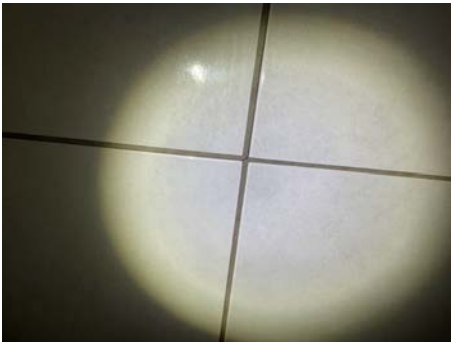
Riss og løse fuger i dusjhjørnet
