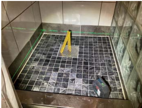
Mange løse fliser inne i dusjen.
