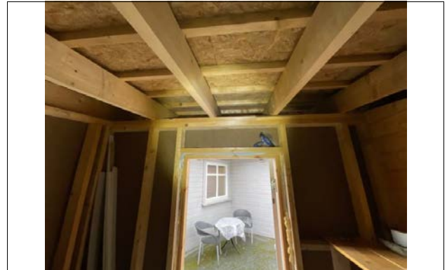
Det mangler bæring over døråpning i boden
