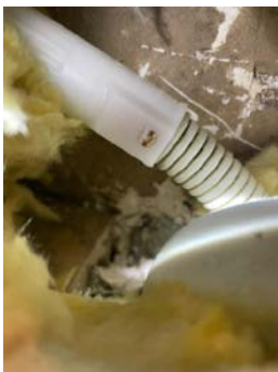
Bilde tatt fra hulltaking i trapperom viser oppsmuldret gips.
