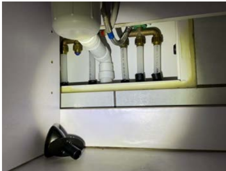
Vannskap på bad på loft er ikke tett
