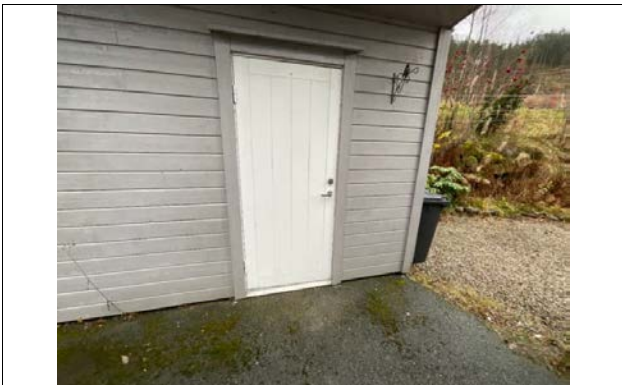
Det er kort avstand fra dør/kledning til terreng/asfalt
