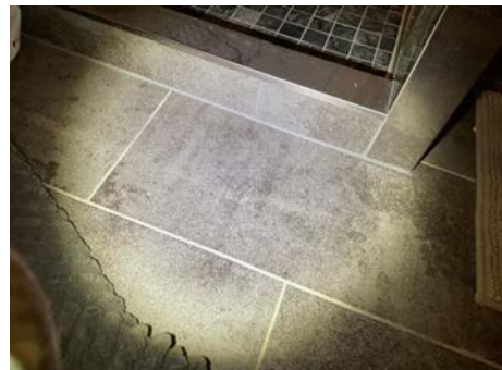
Løse fliser på hovedgulvet
