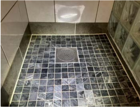
Riss og løse fuger i dusjhjørnet, gjelder på generelt grunnlag.
