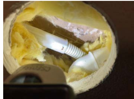
Det er tegn til utettheter i våtsone. Bilde tatt fra hulltaking.
