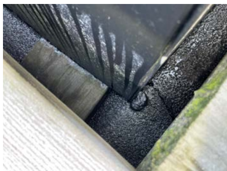
Synlig sveisepap ved gjennomføring av pipe
