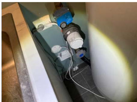
Stoppekran plassert på Vaskerom
