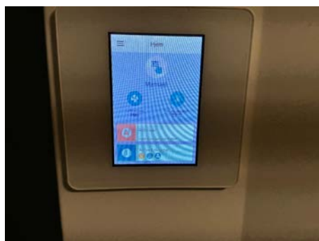
Varsel på display må sjekkes og utbedres.
