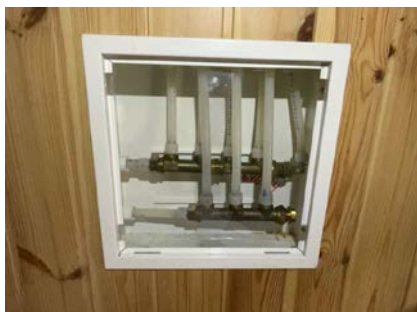
Vannfordelerskap uten kursmerking.
