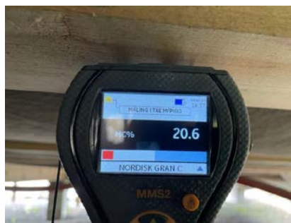
Fuktmåling - Noe høyt trefukttinnhold / vektprosent i skillekonstruksjonen.
