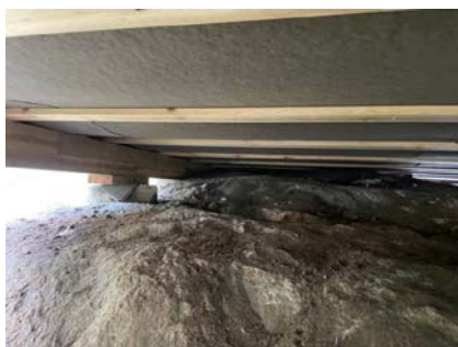
Skillekonstruksjon nær terreng.
