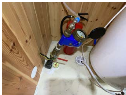
Innvendig stoppekran og vannmåler.
