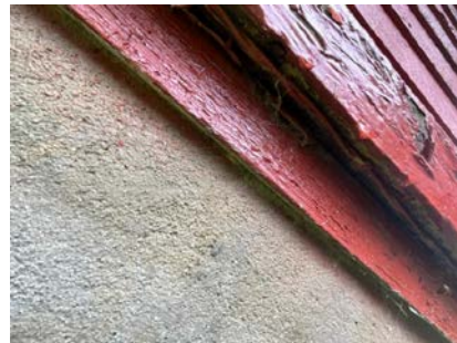
Ingen lufting bak kledning.
