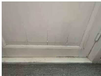
Balkongdør med gjennomgående sprekk i dørbblad.
