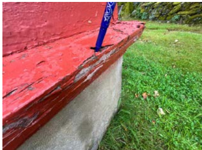
mykt treverk enkelte steder i bunnstokk.
