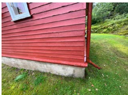
Noe flassing og sprekker i treverk.
