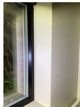
Noe slitasje på foring rundt vindu
