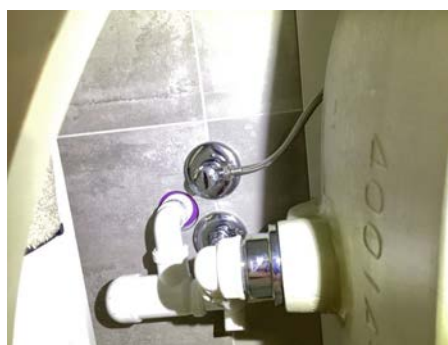
mangler fug rundt avløpsrør
