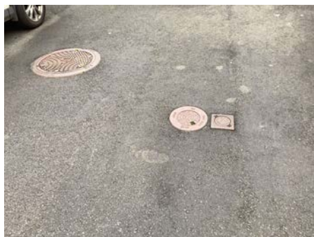
Utvendig stoppekran og stakekum
