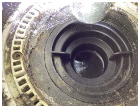
Påvist mansjett under klemring i sluk under kabinett.
