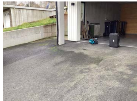
Fall fra grunnmur
