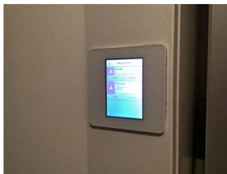
Filter må skiftes
