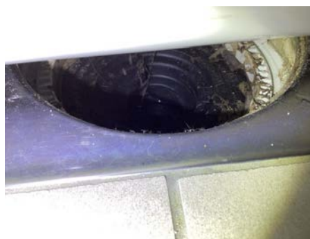
Påvist mansjett under klemring i sluk under badekar
