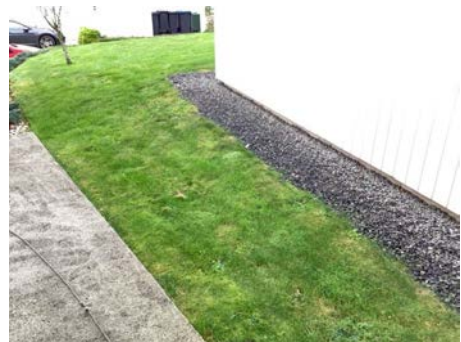
Fall fra grunnmur
