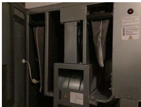
Filter må skiftes
