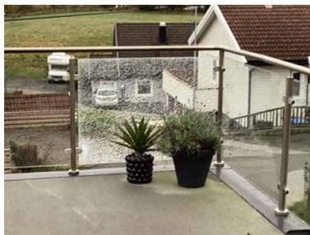
Knekt glass i rekkverk
