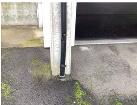
Skade på et nedløp
