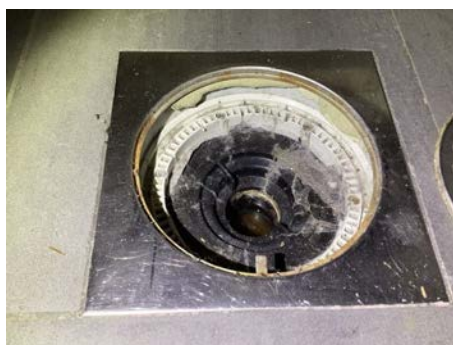
Påvist mansjett under klemring i sluk.
