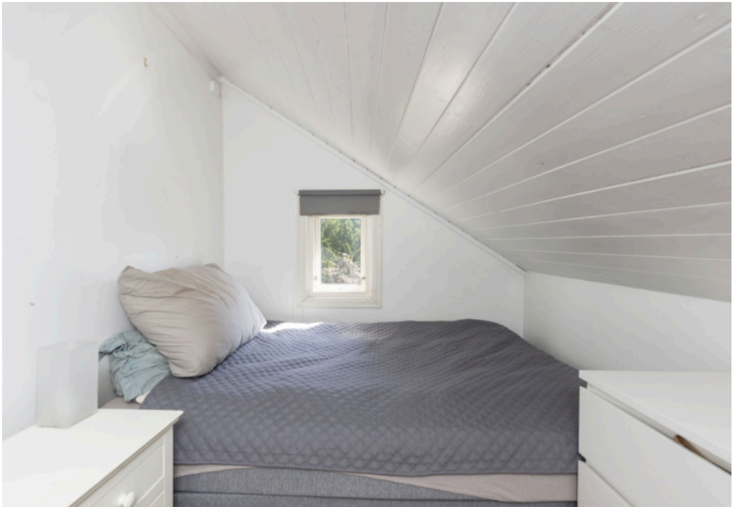
2. etasje: Sovealkove (vindu oppfyller ikke krav til rømningsvei pga størrelse)
