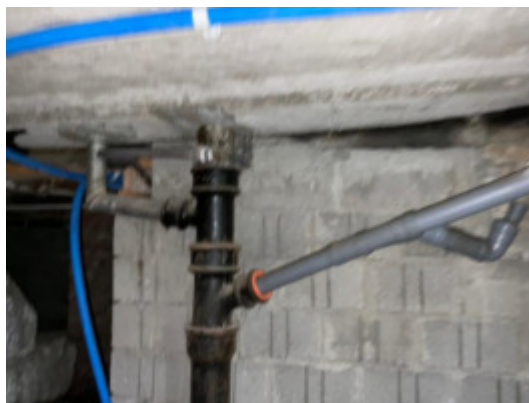
Det er ulik alder på avløpsrør
