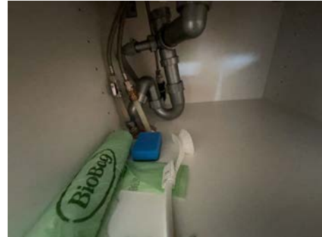
Foto viser avløpsrør under hytten som er rullet inn i Glava isolasjon.
