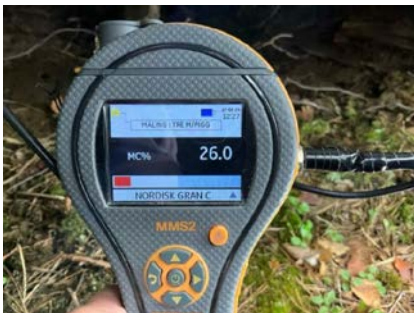
Fuktmåling - Skillekonstruksjon - Høyt trefuktinnhold / vektprosent.
