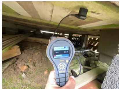
Fuktmåling - Høyt trefukttinnhold / vektprosent i skillekonstruksjonen.
