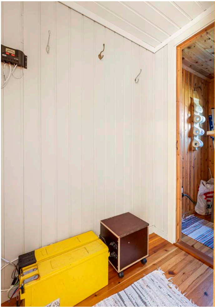
Innlagt solcellepanel i hytta
