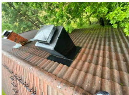
Pipebeslag på den ene av to piper.
