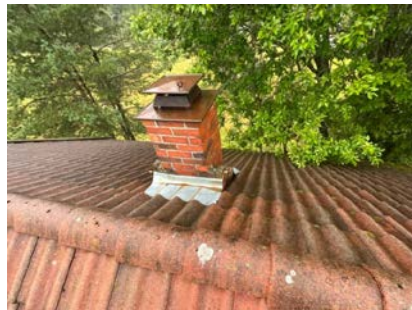
Pipe kan med fordel beslås.
