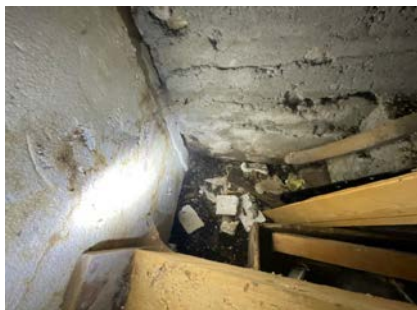
Saltutslag og fritt vann på gulv rundt lufting av avløp.
