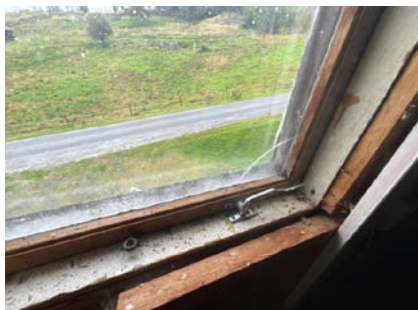
Sprekk i rute på loft.
