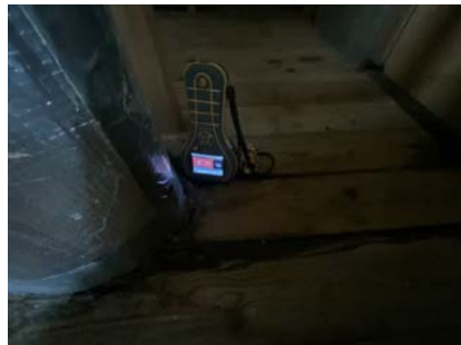
Fuktmåling i gulv i andre etasje viser høye verdier.
