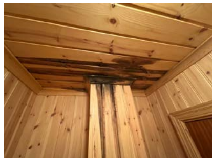
Skader i tak på toalettrom.
