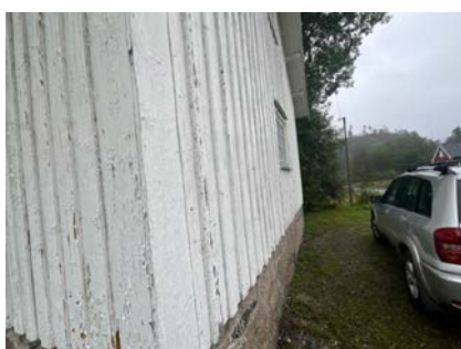
Noe flassing av maling.
