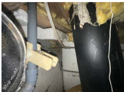
Vannrør av plast og kobberkran.
