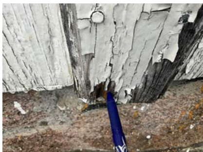
Mykt treverk i nedre del av kledning.
