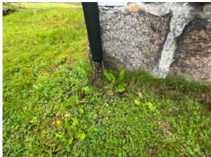
Nedløpsrør er ikke ført i rør ved grunn.
