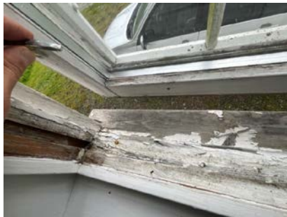
Noe slitasje på vindu på kjøkken.
