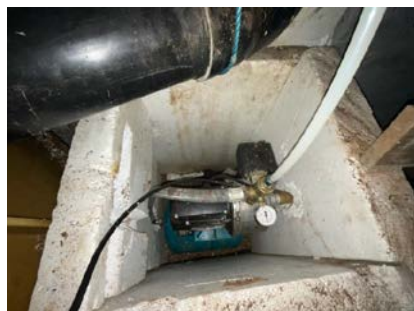
Pumpe i isolert kasse.
