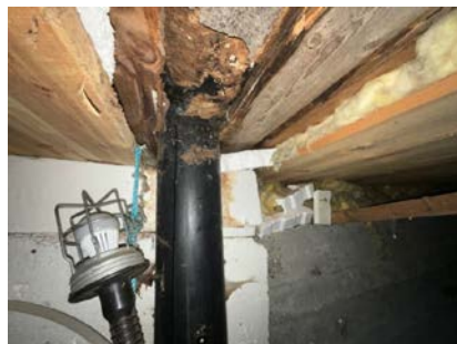
Synlig vann på lufting av avløp.
