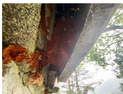
Ingen lufting bak kledning.
