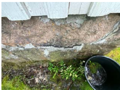
Sten har løsnet noe i mur.
