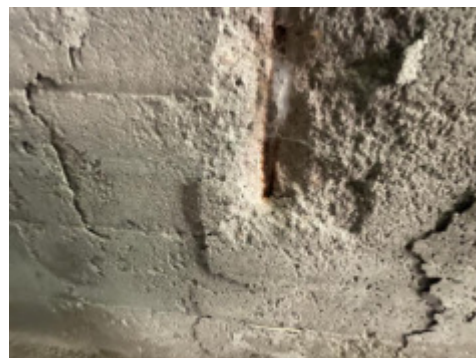
Synlig armeringsjern i betongdekke
