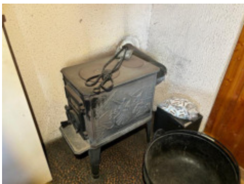
Røykrør bør monteres høyere opp på vegg
