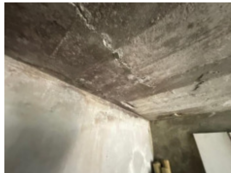
Sprekk i betongdekke
