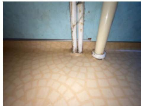
Utette rørgjennomføringer i gulv
