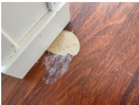
Skade i laminat
