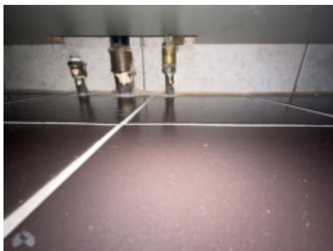
Rørgjennomføring i gulv
