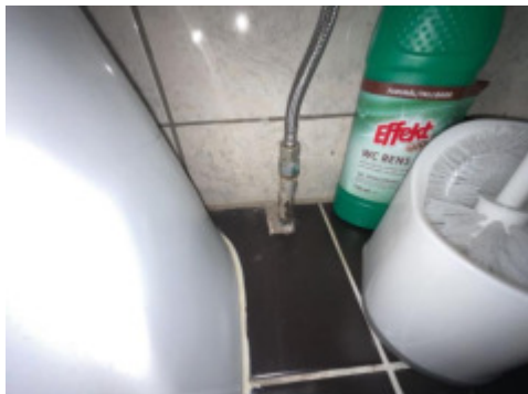
Rørgjennomføring i gulv
