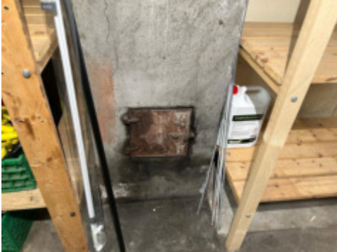
Sprekk i pipestamme, rust på sotluke, merker etter sotvann
