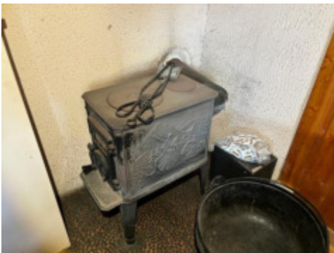
Røykrør bør monteres høyere opp på vegg
