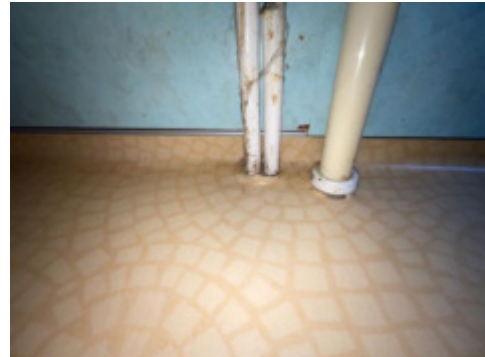
Utette rørgjennomføringer i gulv
