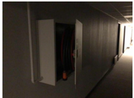
Vann slange som rekker inn til leilighet.
