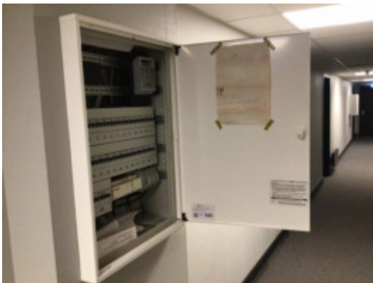
Sikringskap i felles gang.
