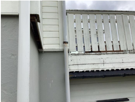
Rust på klammer
