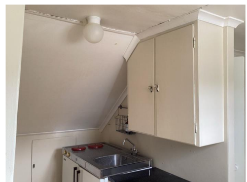
Kjøkken har ikke avtrekk
