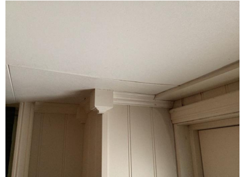
Kjeller, indikasjon på eldre fuktskade.
