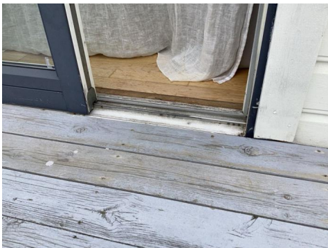
Høyde fra dekke til dør er for liten og dekket er slitt
