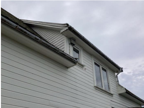
Råteskade i gesims og vindskier
