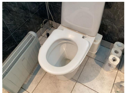
Lokk må skiftes
