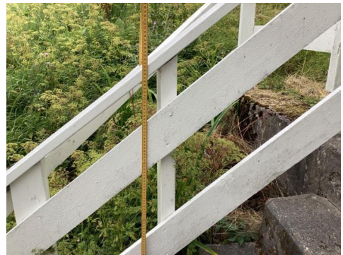
Rekkverk er lavere enn dagens krav.
