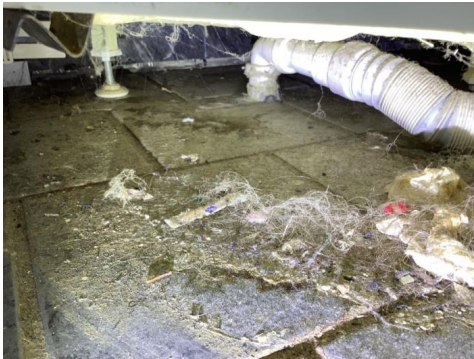
Avløp fra kabinett går direkte ned i gulv, en løsning som ansees som en risiko og fare for vannskader i konstruksjoner.
