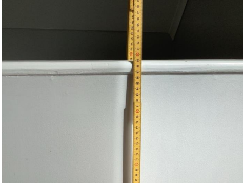
Rekkverk lavere enn dagens krav.
