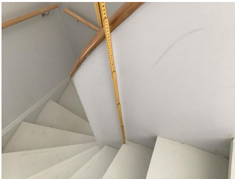
Rekkverk lavere enn dagens krav.
