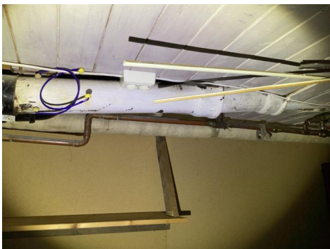
Avløpsrør i sol med overgang til plast
