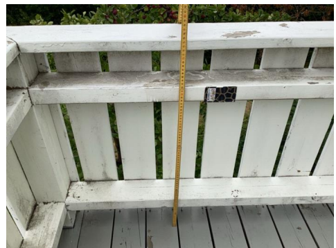
Rekkverk er lavere enn dagens krav
