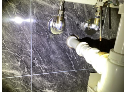
Mangler mansjett rundt avløpsrør
