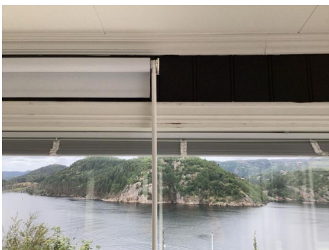
Spor etter vannskade.
