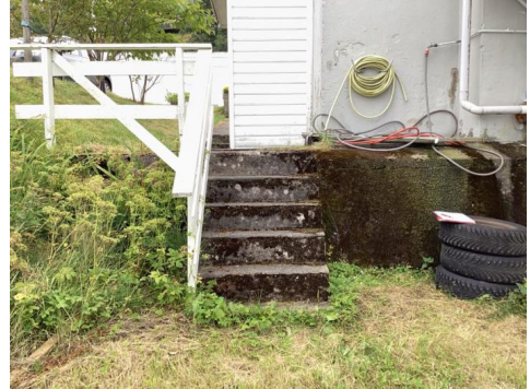
Det mangler rekkverk på en side
