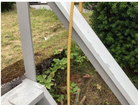
Rekkverk er lavere enn dagens krav.
