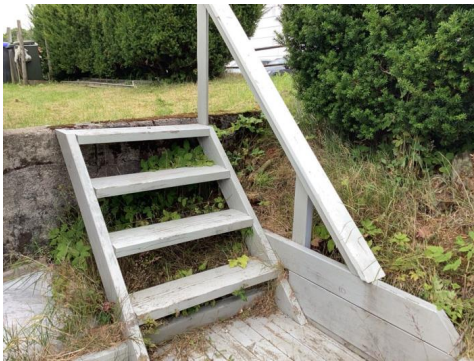
Åpninger i rekkverk er større enn dagens krav.
