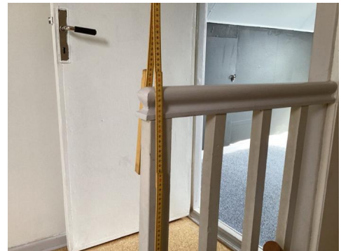
Rekkverk lavere enn dagens krav.
