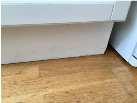
Skader på sokkel
