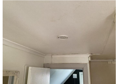
Varsler på loft er tatt ned
