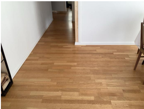
Sporadiske plasser med hulerom under parkett, gulvet gir etter når man går på det.
