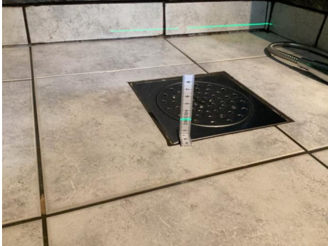
Måling ved sluk i nisje. sluk er plassert høyere enn øvrig gulv
