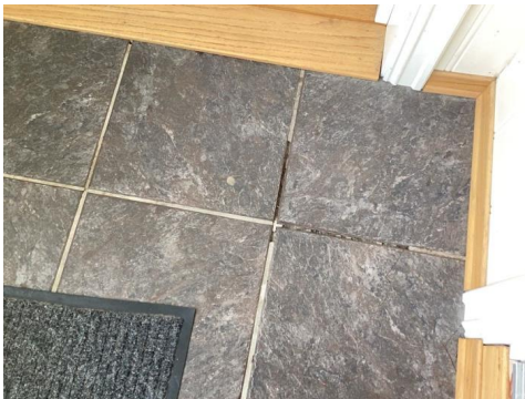
Sprekk i fuger og bom
