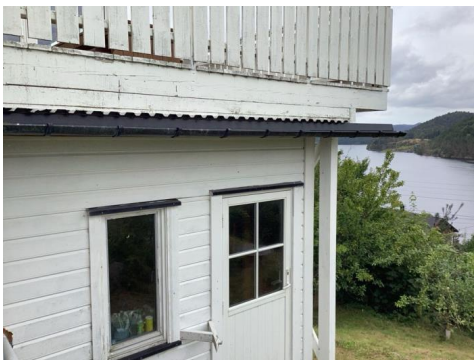
Renne mangler nedløp
