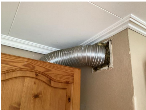
Avtrekk går til et pipeløp
