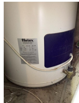
Tank har ikke avrenning til sluk
