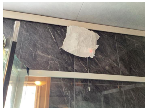
Det mangler tilluft til våtrom
