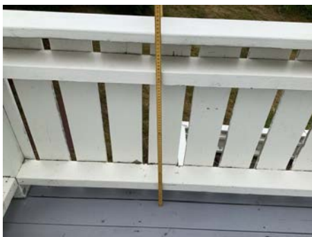
Rekkverk er lavere enn dagens krav
