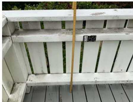
Rekkverk er lavere enn dagens krav
