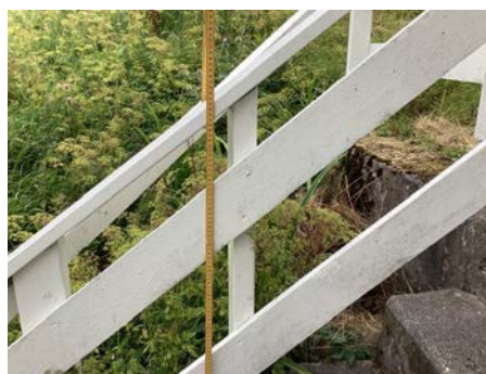
Rekkverk er lavere enn dagens krav.
