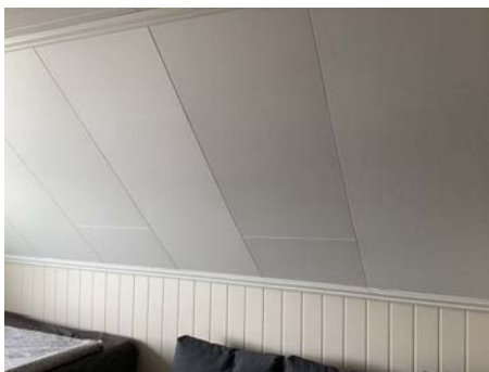
2 etg, ujevn overflate
