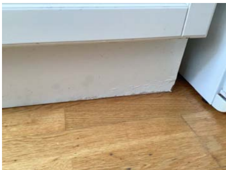
Skader på sokkel
