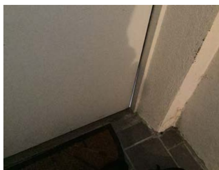
Dør til kjeller er det utett mellom karm og blad
