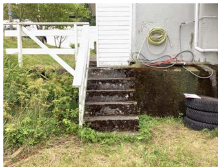
Det mangler rekkverk på en side
