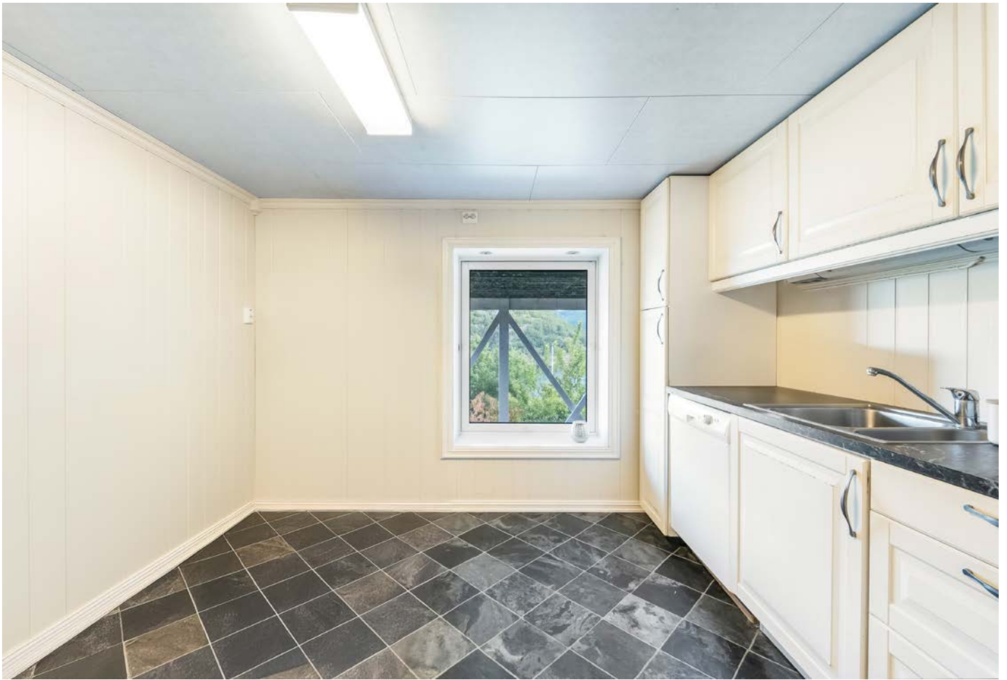
Rom i kjelleretasjen er innredet og ikke søkt bruksendret til rom for varig opphold.
