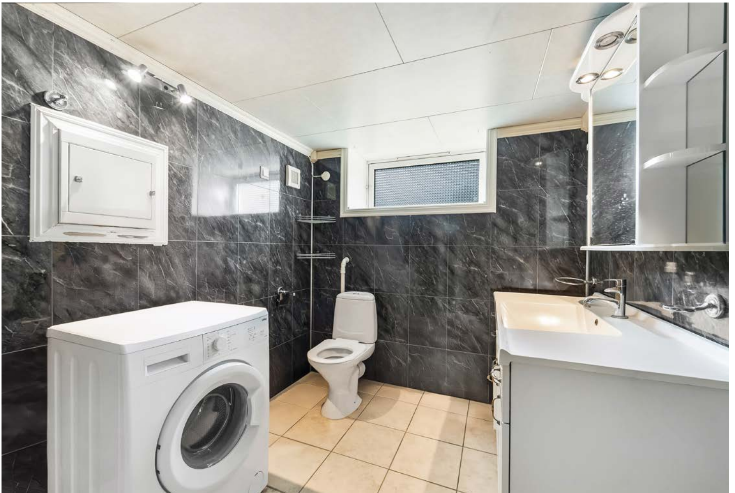
KjellerstueRom i kjelleretasjen er innredet og ikke søkt bruksendret til rom for varig opphold.
