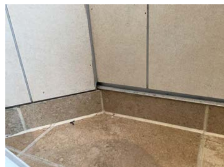
Montering som avviker fra monteringsveiledning.
