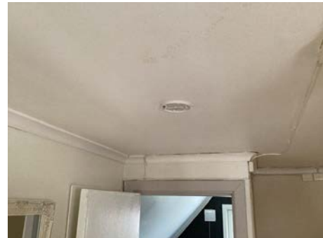
Varsler på loft er tatt ned
