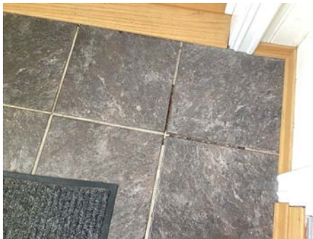
Sprekk i fuger og bom
