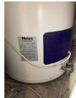
Tank har ikke avrenning til sluk
