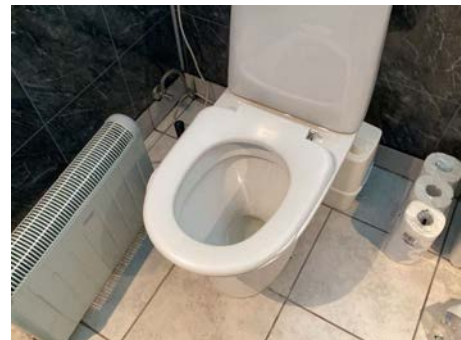
Lokk må skiftes
