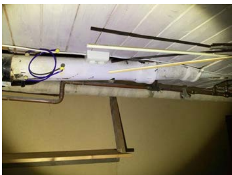
Avløpsrør i sol med overgang til plast
