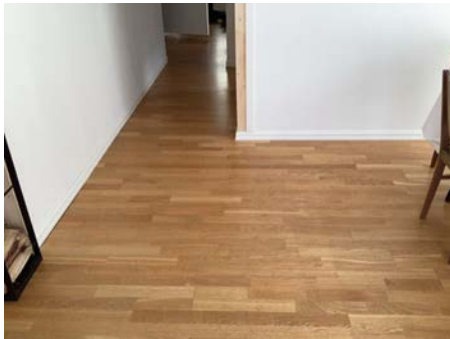
Sporadiske plasser med hulerom under parkett, gulvet gir etter når man går på det.
