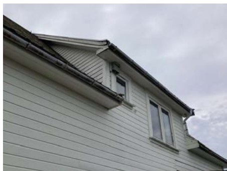
Råteskade i gesims og vindskier
