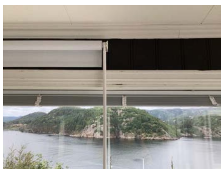
Spor etter vannskade.
