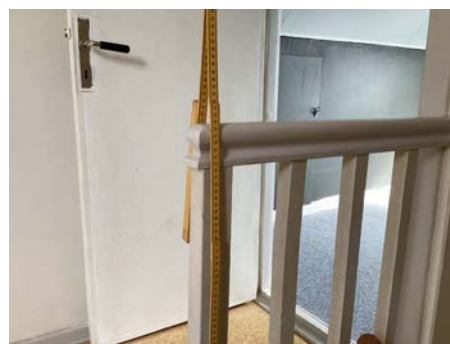
Rekkverk lavere enn dagens krav.
