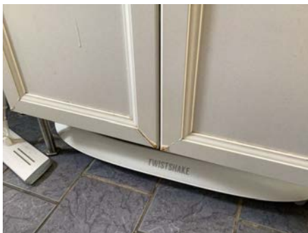
Fuktskader på dører til innredning.
