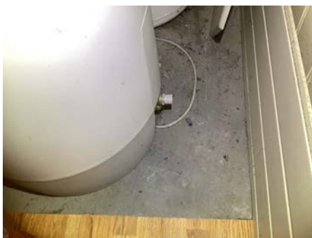
Tank har ikke avrenning til sluk
