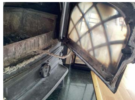
pakning må skiftes
