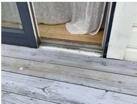
Høyde fra dekke til dør er for liten og dekket er slitt
