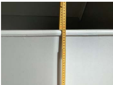
Rekkverk lavere enn dagens krav.
