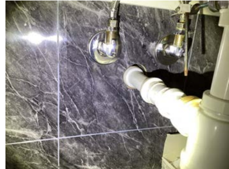
Mangler mansjett rundt avløpsrør KJELLER > BAD/VASKEROM
