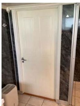
Rommet mangler tilstrekkelig tilluft
