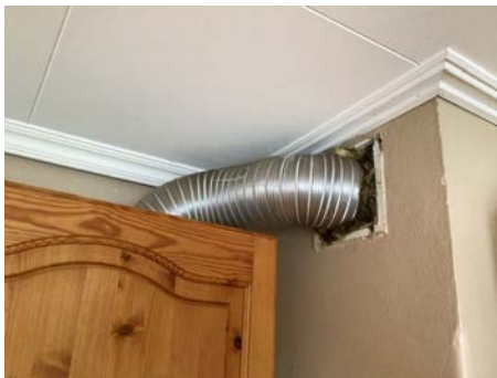
Avtrekk går til et pipeløp
