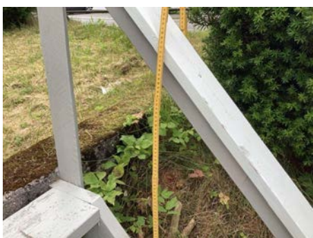
Rekkverk er lavere enn dagens krav.
