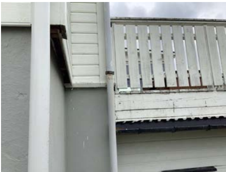
Rust på klammer
