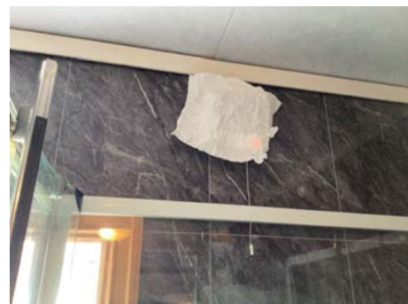
Det mangler tilluft til våtrom
