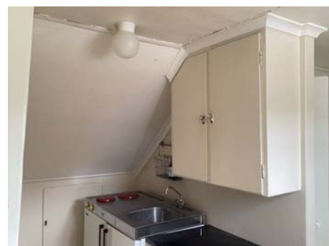
Kjøkken har ikke avtrekk
