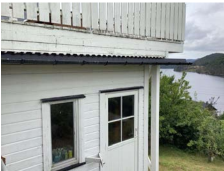
Renne mangler nedløp
