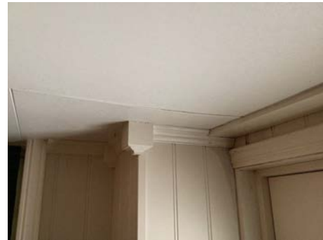
Kjeller, indikasjon på eldre fuktskade.
