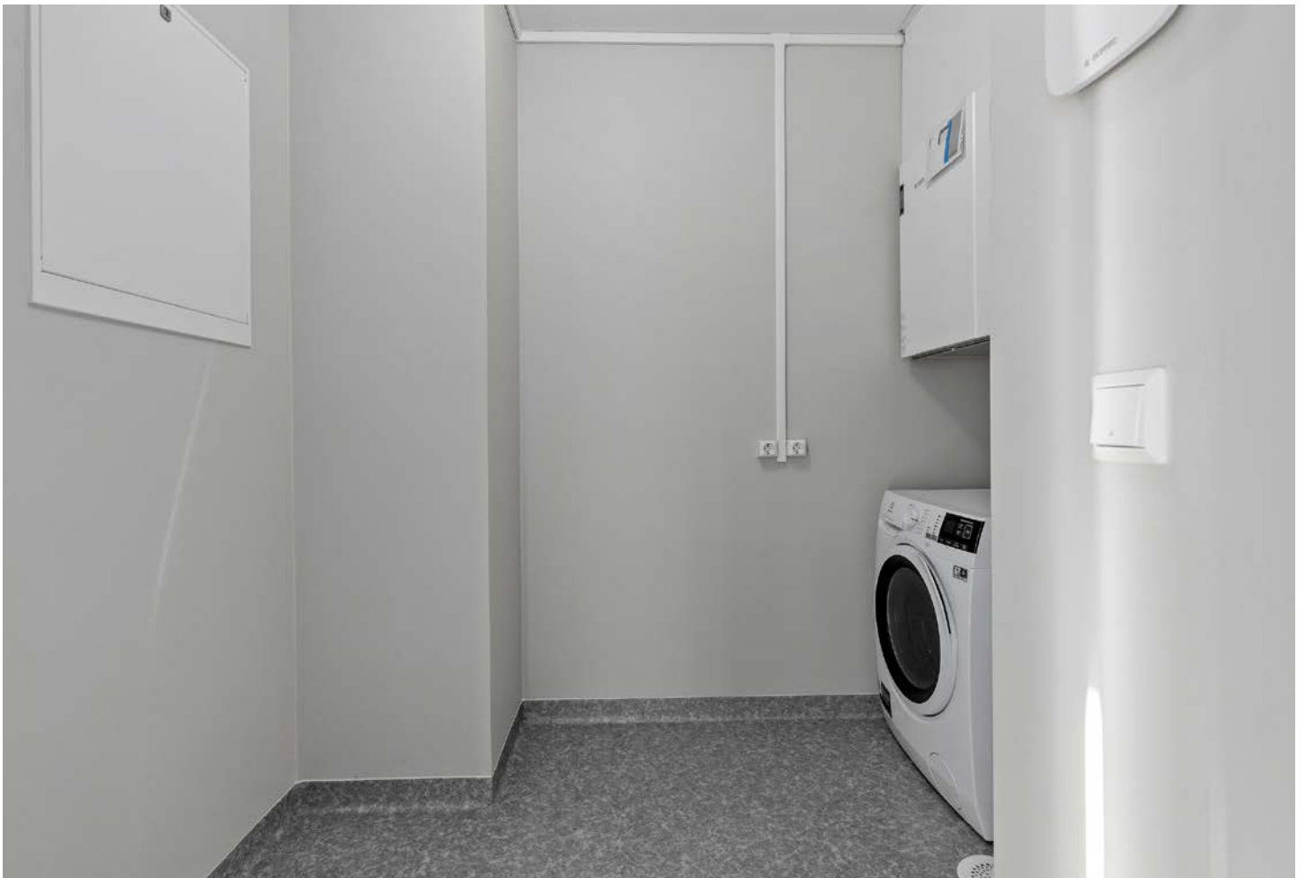
Praktisk tekniskbod med opplegg til vaskemaskin
