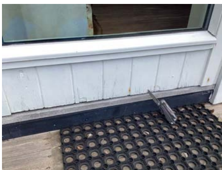
Råteskader i panel på dør.
