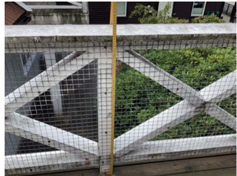
Rekkverk lavere enn dagens krav.
