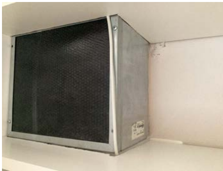
Avtrekkсанlegg på kjøkken
