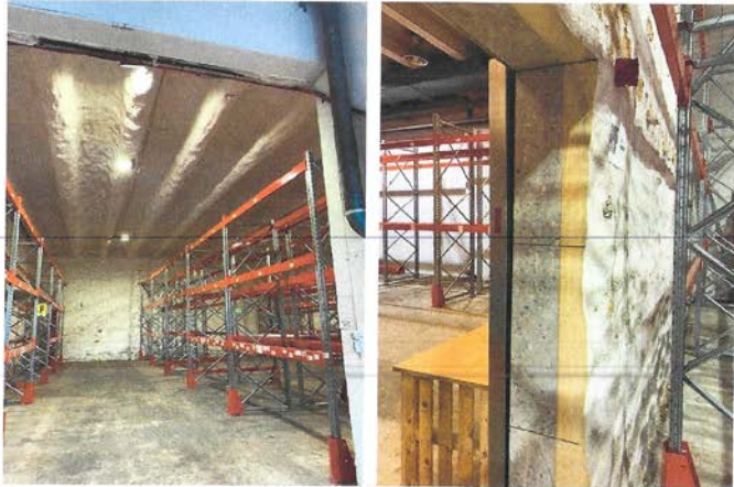
Lager del som tidligere ble brukt som fryseler. Himling og vegger er sprøyteisolert med isolasjons skum.
