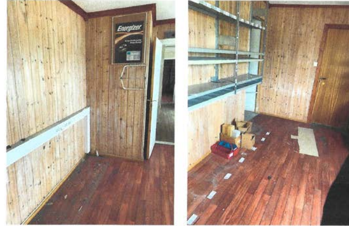
Ekseple på overflater som ikke er pusset opp og som er fra 1979 – 1981.
