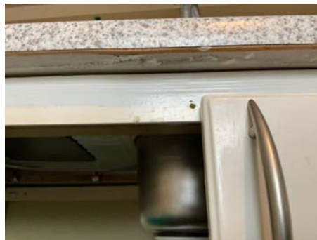
Svelling i benkeplate.
