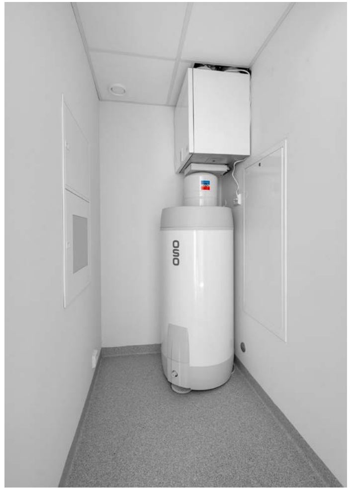
Teknisk rom/ bod
