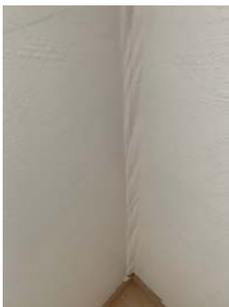
Noe bulkete tapet i hjørne i loftstuen. TG 2 på anmerkninger.
