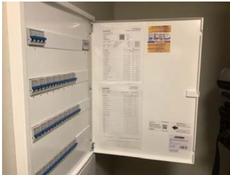
Sikringskap i hoveddel montert i tekniks-rom.
