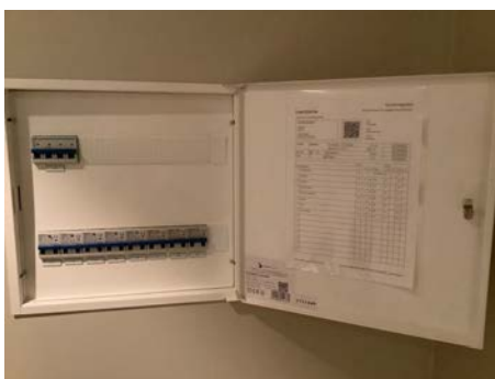
Sikringskap i praktikantdel.
