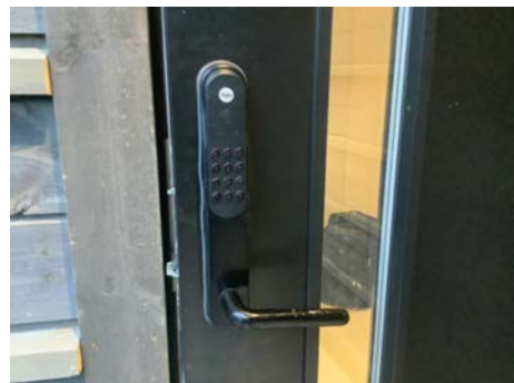
YALE-kodelås er montert ved inngangsdør i 1. etasje.
