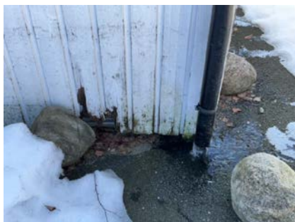
Fukt / råteskader i yttervegg.
