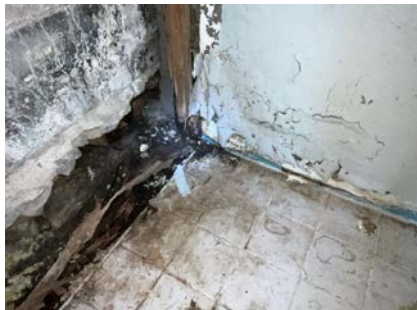
Råteskader i trekonstruksjon mot gulv.
