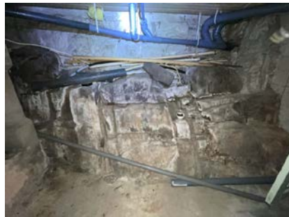
Fuktinnsig på fjellterreng.
