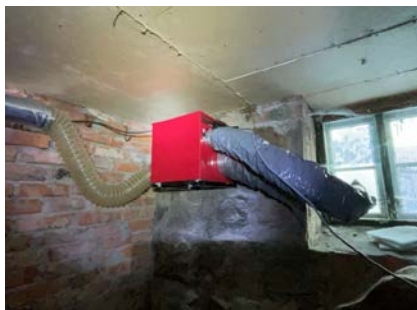
Avfukteranlegg / Rotoravfukter - Ute av drift på befaringstidspunktet.
