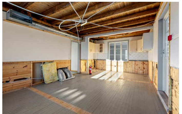
Demontert / revet kjøkken i hovedetasjens opprinnelige del. Kjøkkenet er demontert / revet i forbindelse med vannlekkasjer fra rørapplegget
