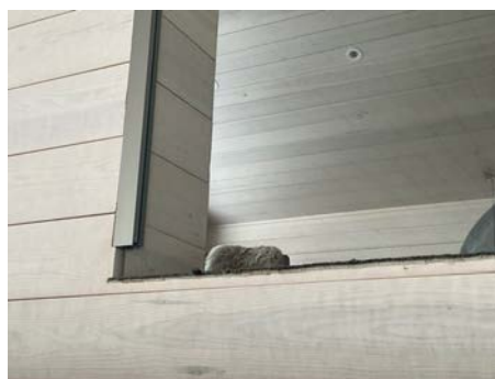
Mangler litt belistning i glass på loft, over kjøkken.
