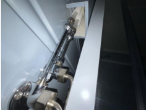
Rør ført på vegg.
