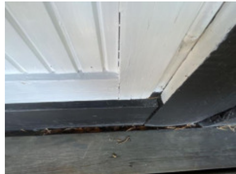
Vær/aldersslitasje på terrassedør.
