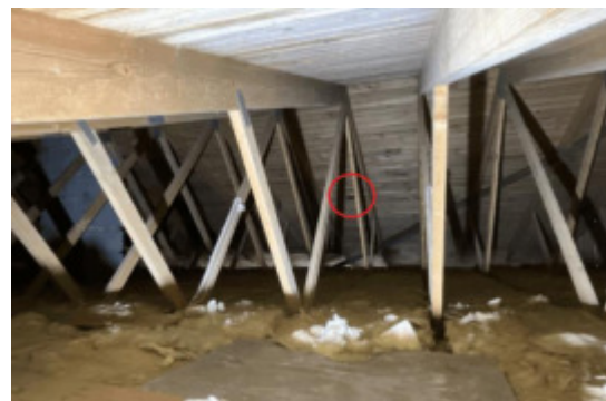
Skade i bordtak og synlig shingel i rød sirkel.
