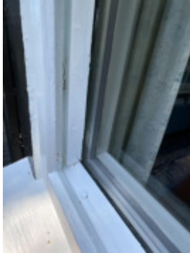
Vær/aldersslitasje og flasket maling på innsiden av rute.
