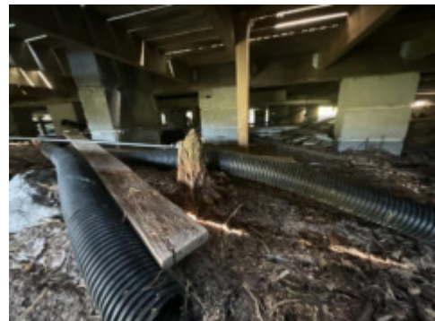
Skade på pilar.
