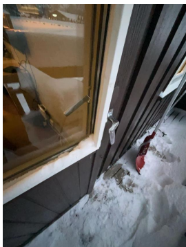
Ødelagt dørveider til terrassedør.
