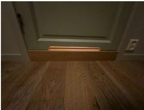
Spalte under dør.
