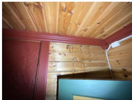
Det er noen fuktskjolder etter brannslukking i følge eiere.
