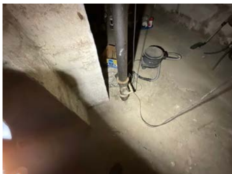
Stakeluke er festet med skrutvinge pga. defekte fester.
