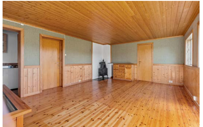
Rom benyttet som kjellerstue (opprinnelig godkjent som hobbyrom)
