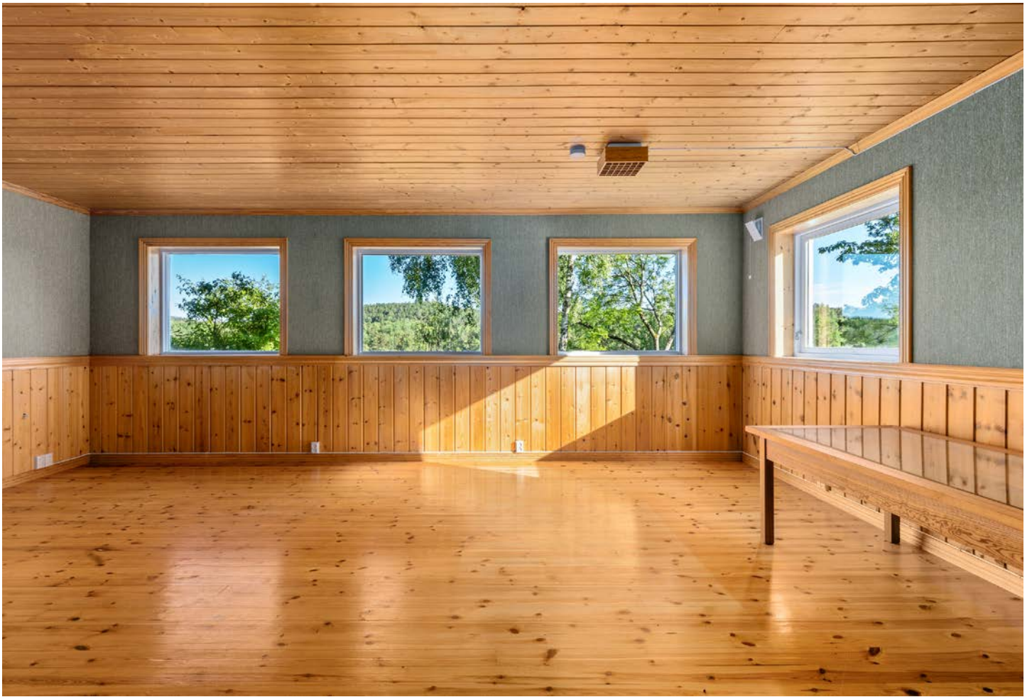
Rom benyttet som kjellerstue (opprinnelig godkjent som hobbyrom)
