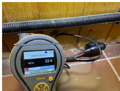
Oppfuktet trepanel mot gulv.
