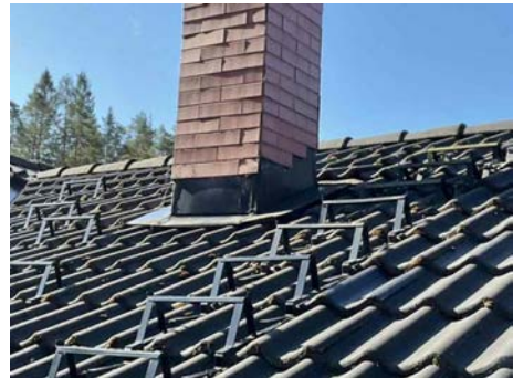
Pipebeslag er ikke fagmessig utført.
