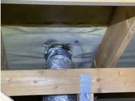
Mindre lekkasje fra takgjennomføring
