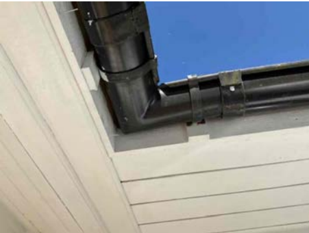
Lekk i enkelte renneskjøter.
