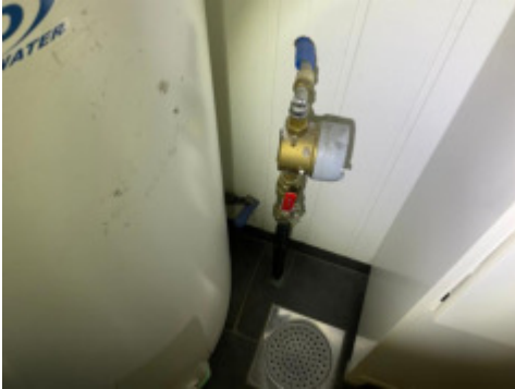
Hovedstoppekran på vaskerom
