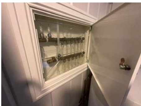
Skap til rør i rør system.
