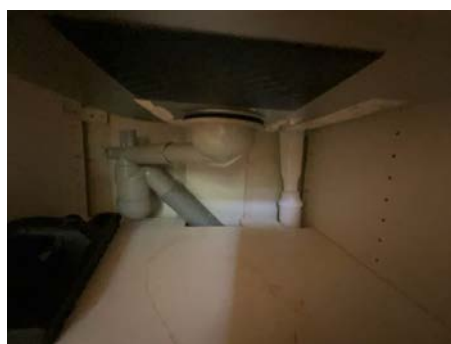
Del av rør til avløp.
