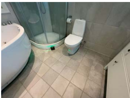
Målt fall på gulv.
