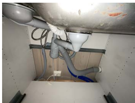
Del av rør til avløp.
