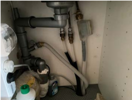
Rørprolegg i skap under vasken.
