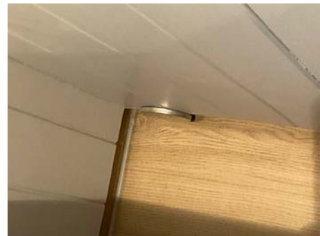
Drenering ut fra rør i rør skap.
