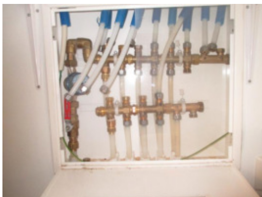
Innvendig stoppekran og vannmåler i fordelerskapet.
