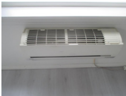
Varmepumpe i stue.
