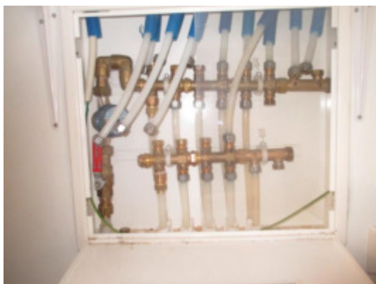
Innvendig stoppekran og vannmåler i fordelerskapet.
