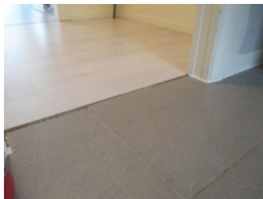
Lav høyde til bod i forhold til topp sluk.
