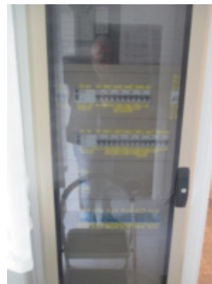
Stort sikringsskap i hall med merkede kurser.
