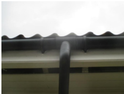
Takrenner og nedløp av plast.
