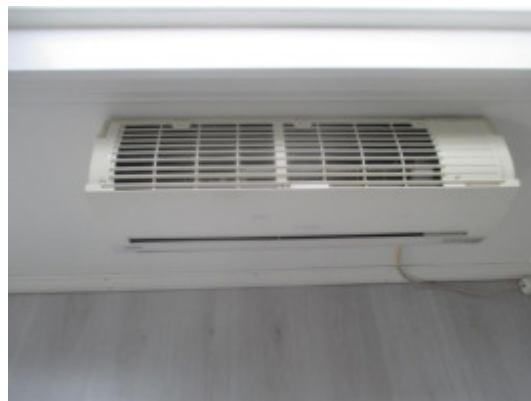
Varmepumpe i stue.
