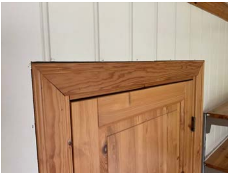
Bilde viser eks. på ikke fagmessig utførelse, panelplater tilpasset rundt belistning
