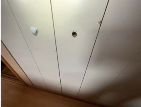
Bilde viser eks. på skadet dør på plassbygd garderobe
