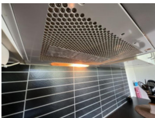
Foto viser funksjonstest av avtrekk med papir.
