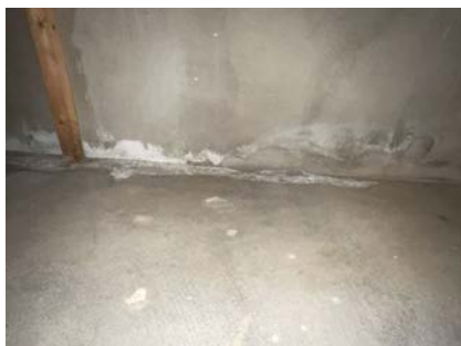
Synlig kalkutslag på innvendig side av tilbakefylt mur.
