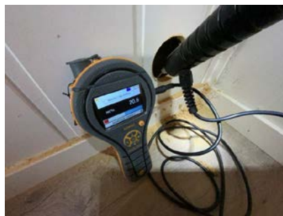
Hulltaking - Fuktmåling - Noe høyt trefuktninnhold / vektprosent i konstruksjonen.
