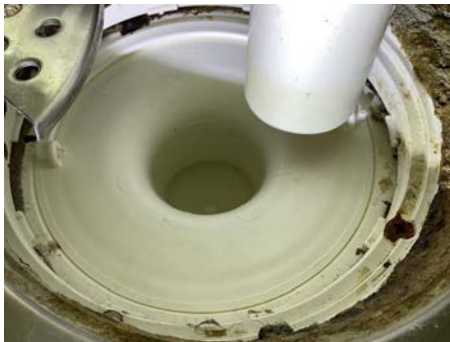
Påvist mansjett under klemring i sluk
