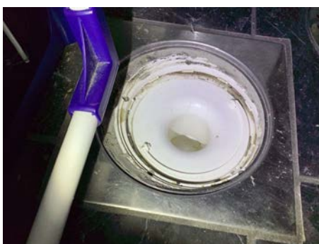
Påvist mansjett under klemring i sluk
