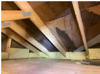
Synlige kondensskader i undertak - Tilbygg
