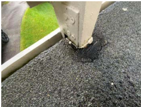
Sprekker i taktekket rundt stolper.
