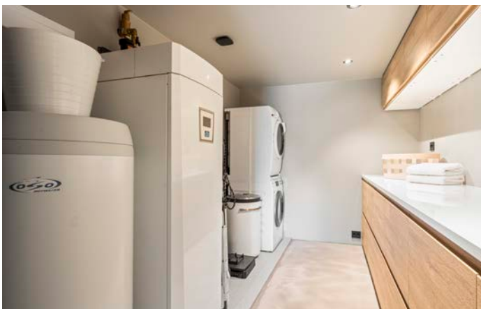
Vaskerom med opplegg for vaskemaskin og tørketrommel. Varmtvannsbereider i vaskerommet og tekn anlegg for det vannbårne
