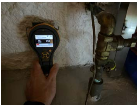
Yttervegg mot inngangsside. Svake/moderate utslag registrert
