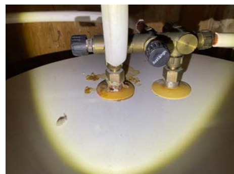
Rustdannelse fra kobling
