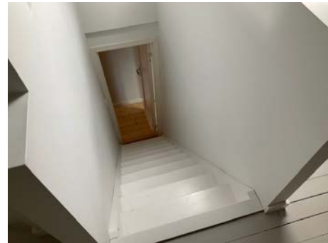
Ny trapp montert til loftsrom. Ingen håndrekker
