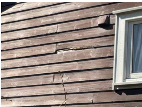
Bilde eks. på slitasje/råte på ytterkledning.
