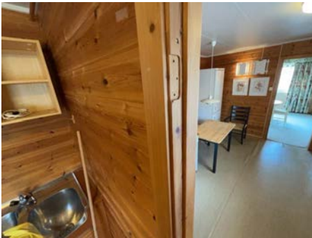
Bilde viser eks. på manglende dørbblad.
