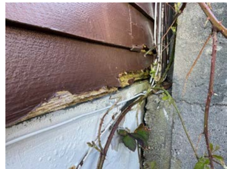
Bilde eks. på slitasje/råte på ytterkledning.
