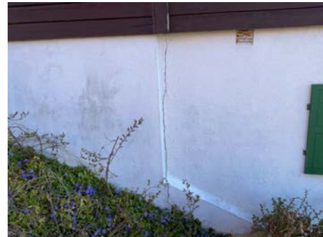
Bilde viser eks. på sprekke i grunnmur.
