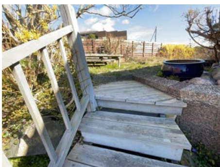
Bilde viser skjevt rekkverk
