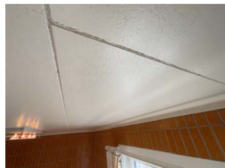
Bilde viser overflateskader på himlingsplater
