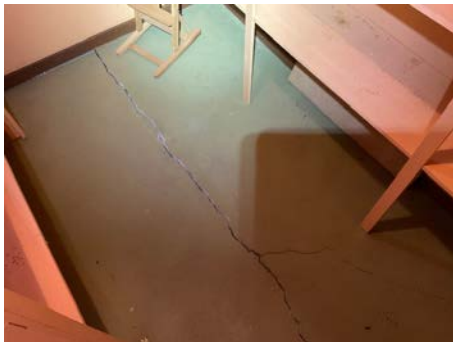
Bilde eks på sprekk i betonggulv i underetasjen
