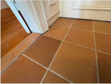
Bilde viser sprekk/avstand mellom fotlist og gulvoverflaten, samt sprekk i elastisk fuge
