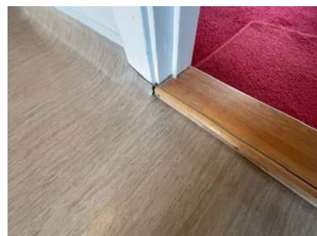
Bilde viser eks. på utett løsning ved dørsvill
