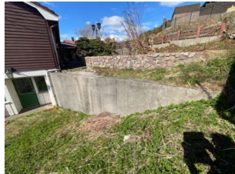
Bilde viser eks. på manglende rekkverk over forstøtningsmur.
