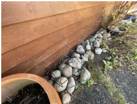
Bilde viser ytterkledning som ligger nærmere bakken/terreng enn anbefalt.
