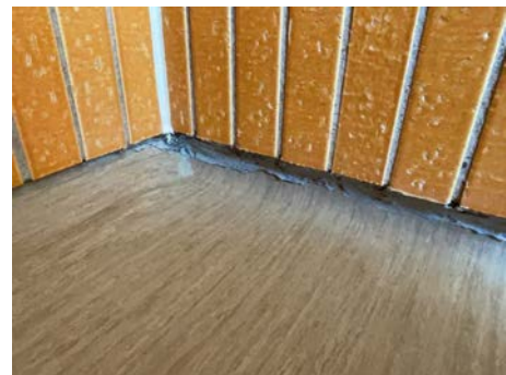
Bilde viser fugging i overgang oppkant og vegg i dusjsone. Indikasjon på mulige utettheter.
