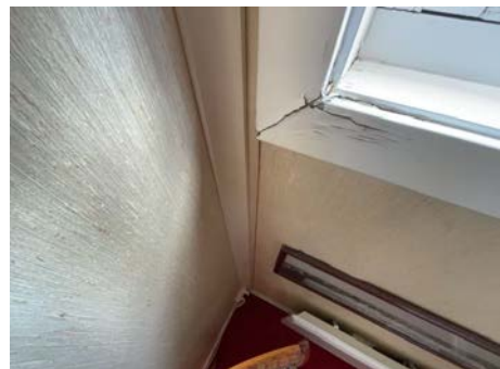
Bilde viser eks. på avflassing av maling, antydning til fuktskader på listverk rundt vindu i gang.
