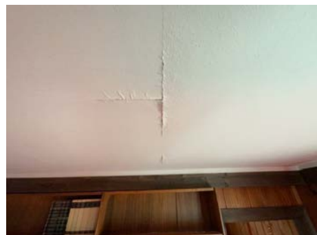
Bilde viser eks. svelleskader i takplater i underetasjen.
