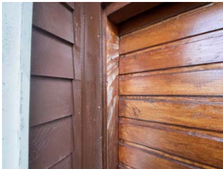
Bilde viser eks. på at garasjeporten står skjevt i åpning og tar i sidekarm/vegg
