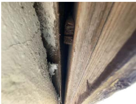
Bilde viser manglende musetetting og noe begrenset lufting i underkant av kledning
