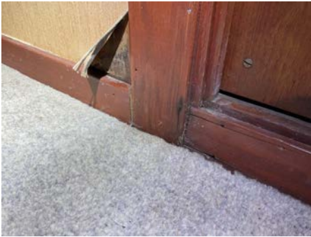
Bilde viser indikasjon på fuktskader ved skyvedør
