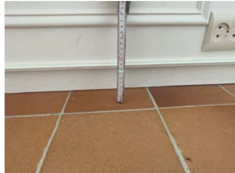
Utkastrek på laser er 11 cm på målestokk. Bilde viser ca. 35 mm høydeforskjell i rommet i allrom.
