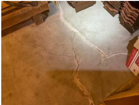
Bilde viser eks. på sprekker i betonggulv
