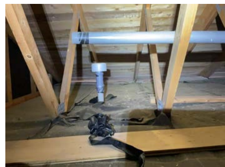
Bilde viser lufting til avløpssystem som stopper på kaldtloft.
